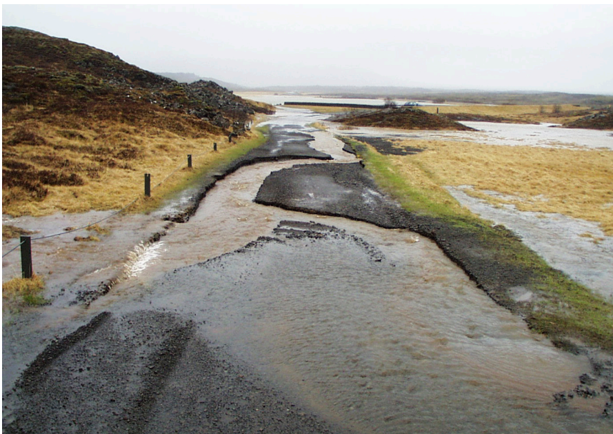
5. mynd. Flóð og vegaskemmdir á Þingvöllum 25. febrúar 2013. – A flood in Óxará damaging the road in Almannagjá on February 25, 2013. Ljósmynd./Photo: Einar Á.E. Sæmundsen.
